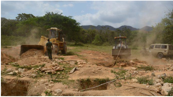
Zona afectada por la minería ilegal
